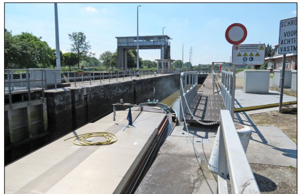
Sluis van Denderbelle moet worden vernieuwd voor de opwaardering van de Dender naar 1350 ton
